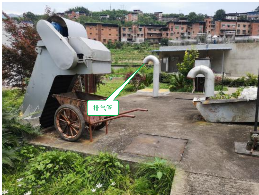
调节池加盖集中排放管
